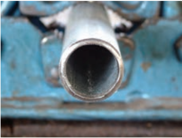
شکل ۲۰-۲- لوله‌ی برقو خورده
