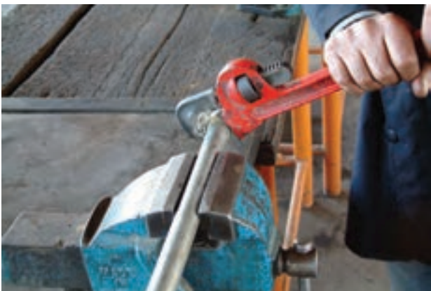
شکل ۱۰۲-۵- روش غلط نگهداری لوله به وسیله‌ی گیره‌ی لوله
