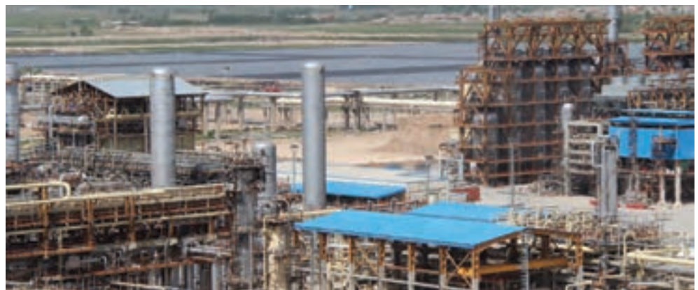
شکل ۴- نمایی از یک برج تقطیر برای جداسازی اجزای هوا در پتروشیمی ماهشهر
