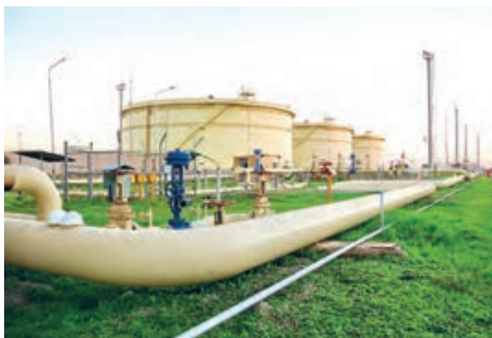
شکل ۲۱- نمایی از خطوط انتقال سوخت
