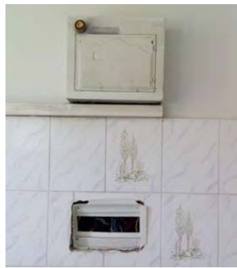
شکل ۵-۲- نصب تابلو فیوز روکار با نوع آسیب دیده توکار
