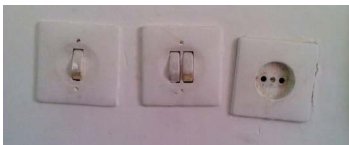
شکل ۵-۱- نصب غلط کلید و پریز
