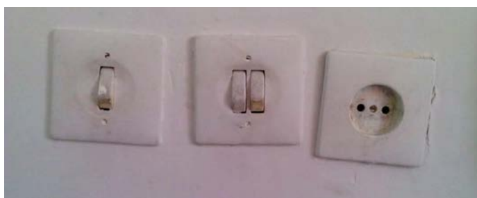
شکل ۵-۱- نصب غلط کلید و پریز
