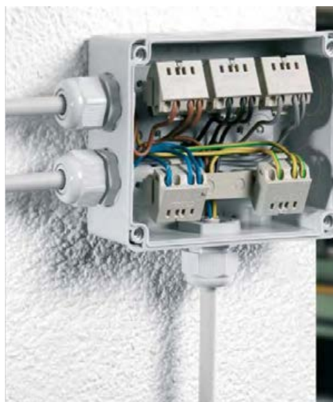
ب) گلند در محل ورود تابلوی برق
