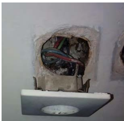
شکل ۵-۳- قاب جداشده پریز از دیوار
