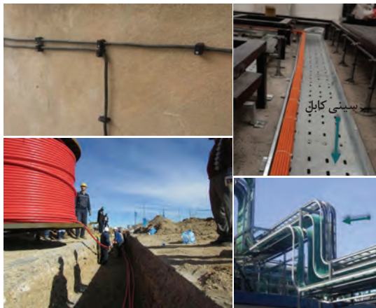
شکل ۱۹- انواع کابل کشی
