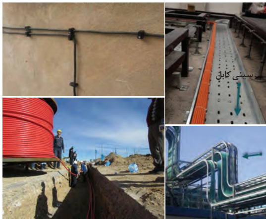
شکل ۱۹- انواع کابل کشی
