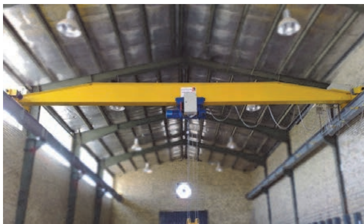
شکل ۲۱- نمایی از جرثقیل سقفی (تک پل)
