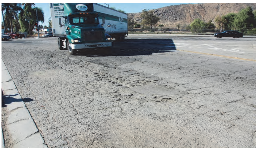
شکل ۱۲- نمونه‌هایی از خرابی‌های روسازی ناشی از ترمز یا وزن زیاد وسایل نقلیه سنگین
