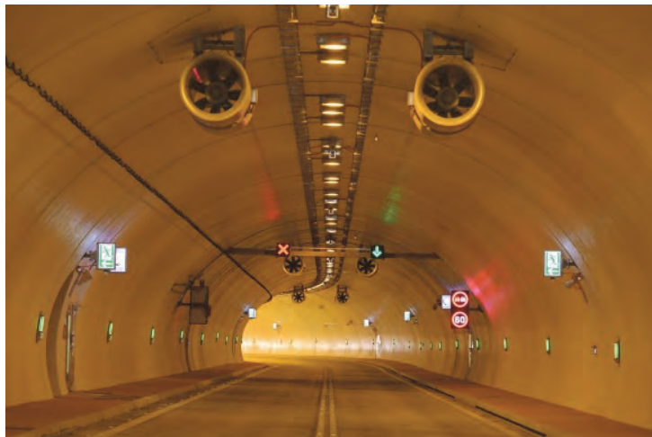
شکل ۱۸- تهویه‌های هوای نصب شده در تونل
