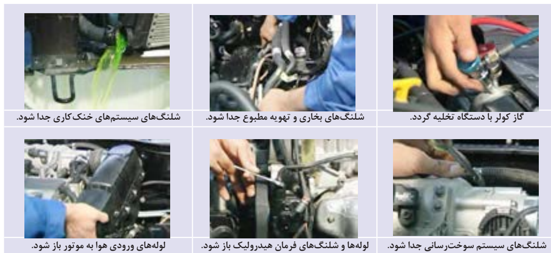
شکل ۸-۹ باز کردن لوله‌های ورودی هوا و شلنگ‌های متصل به موتور
