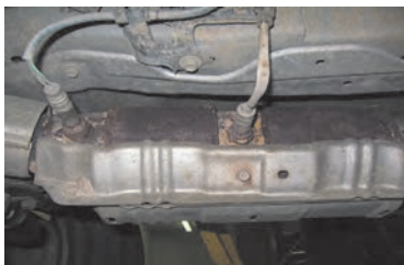
محل نصب حسگر اکسیژن روی میدل کاتالیست
