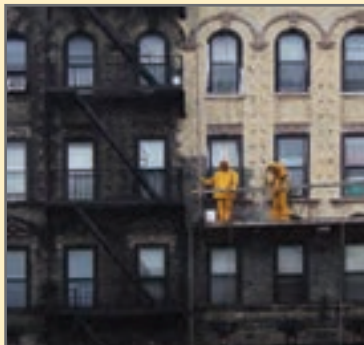
دوده زدایی بر روی نمای ساختمان
