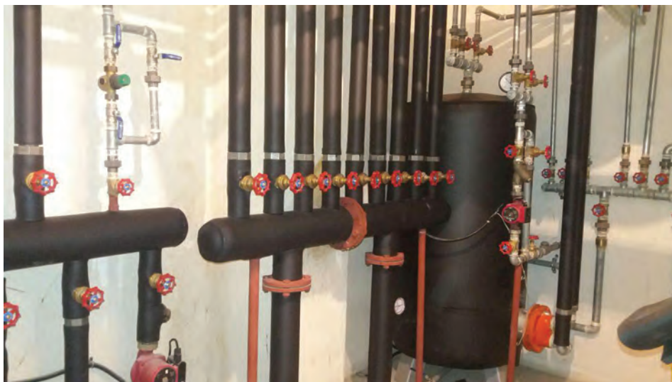
شکل ۲۵- عایق کاری در موتورخانه
