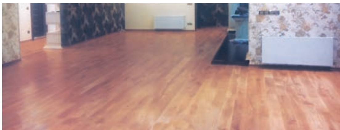
شکل ۸۹ - تصویر محل اتصال کف پوش لمینت به کف آشپزخانه
