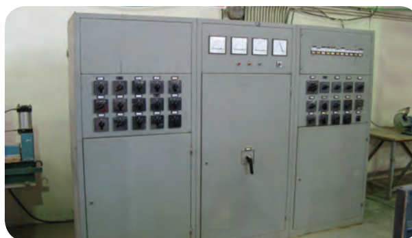
شکل ۸۳-۵- تابلوی اصلی سه فاز برق کارگاه
