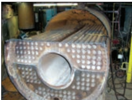
شکل ۴۲-۱ لوله‌ی چدنی دیگ بخار
