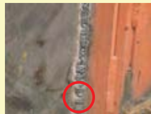
عدم جوش پیوسته - لوچه
