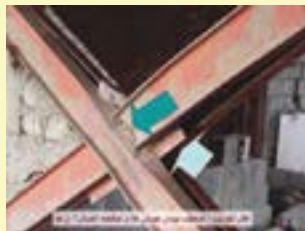
ضعیف بودن جوش و عدم اتصال مناسب
