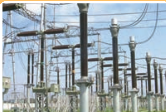
پست تقویت ولتاژ جریان برق
