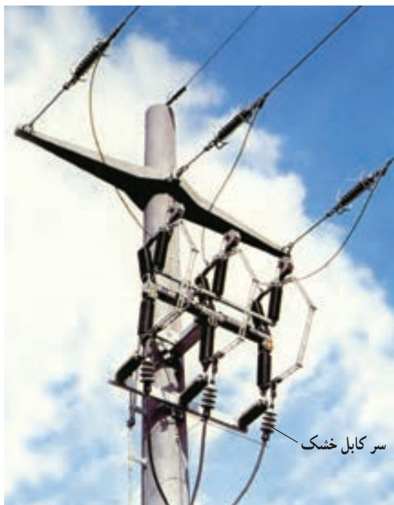
شکل ۶-۶- سر کابل خشک حرارتی هوایی
