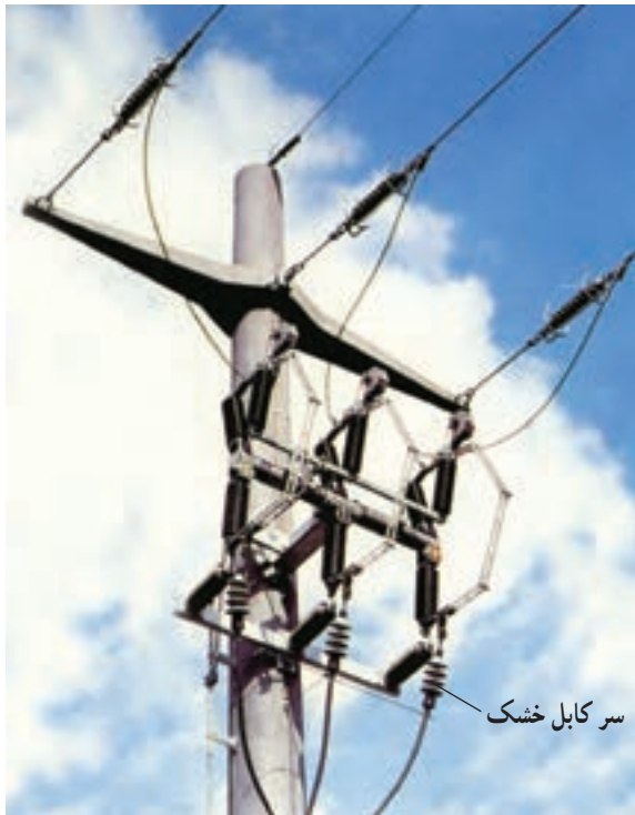
شکل ۶-۶- سر کابل خشک حرارتی هوایی
