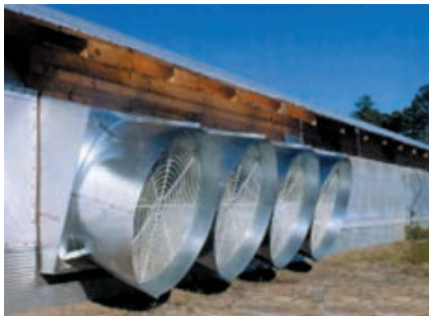
نمای هواکشها از بیرون جایگاه
