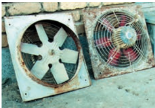
تعویض هواکشهای خراب و فرسوده
