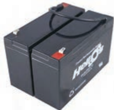
شکل ۱-۲۸ باتری‌های مورد استفاده در داخل تابلو
