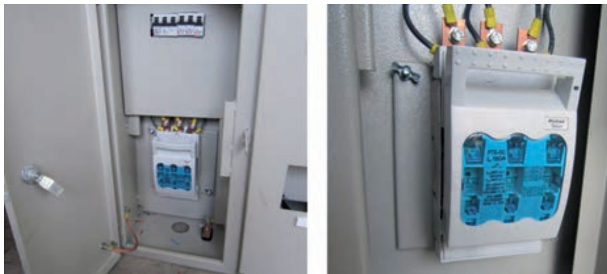
شکل ۲۳-۳- محل ورود کابل اصلی به داخل تابلو
