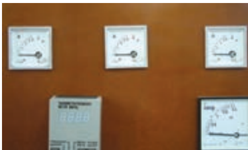
شکل ۱۱-۶- آمپرمترهای اندازه‌گیری جریان فازها
