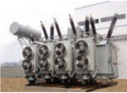
شکل (۳-۱) ترانسفورماتور خطوط انتقال
