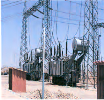
شکل (۲۸-۳) دو ترانسفورماتور موازی شده
