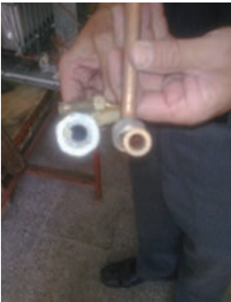
شکل ۱۲-۵- تشکیل رسوب در لوله آب گرم
