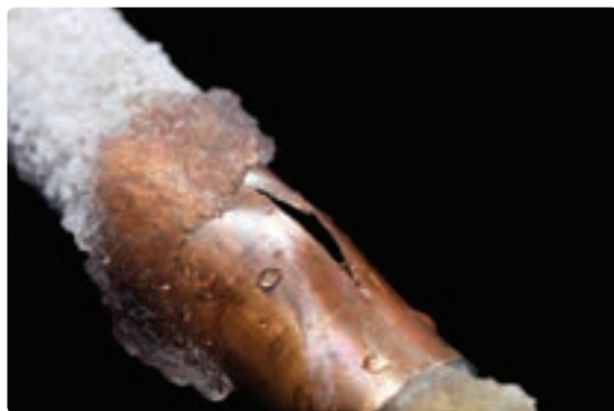
شکل ۶-۵- شکستن لوله آب در اثر انجماد آب
