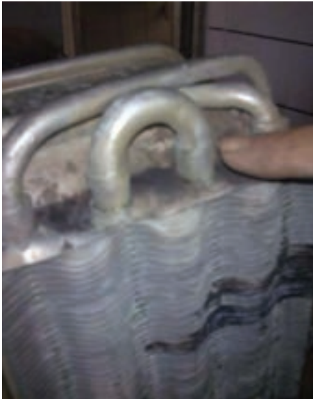
شکل ۱۱-۵- تشکیل رسوب در آب گرم‌کن
