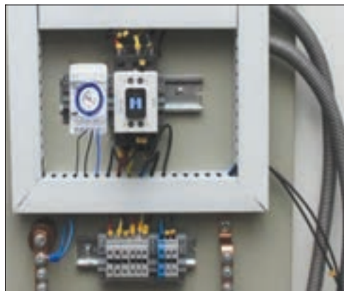
شکل ۱۰۷- محل نصب تایمر ۲۴ ساعت در تابلو روشنایی
