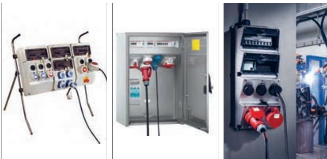
شکل ۶- کاربرد تابلو موقت کارگاهی فلزی و پلاستیکی
