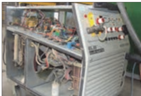
شکل ۱۱- ساختمان داخلی رکتیفایر
