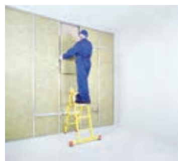
شکل ۱-۶۸- اجرای عایق پشم معدنی در فواصل بین استادها (توجه شود که تأسیسات در مرحله قبل اجرا شده است).
