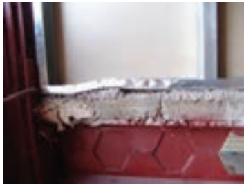
شکل ۷۱-۱- اجرای نامناسب رانر بر روی کف سازه‌ای
