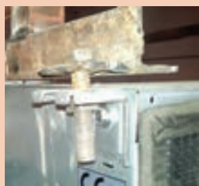
اشکال در نصب
