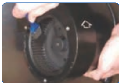
تمیزکردن فن مشعل از گردوغبار
