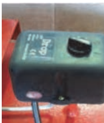
شکل ۱۸۸- جعبه کلید قطع و وصل جریان برق
