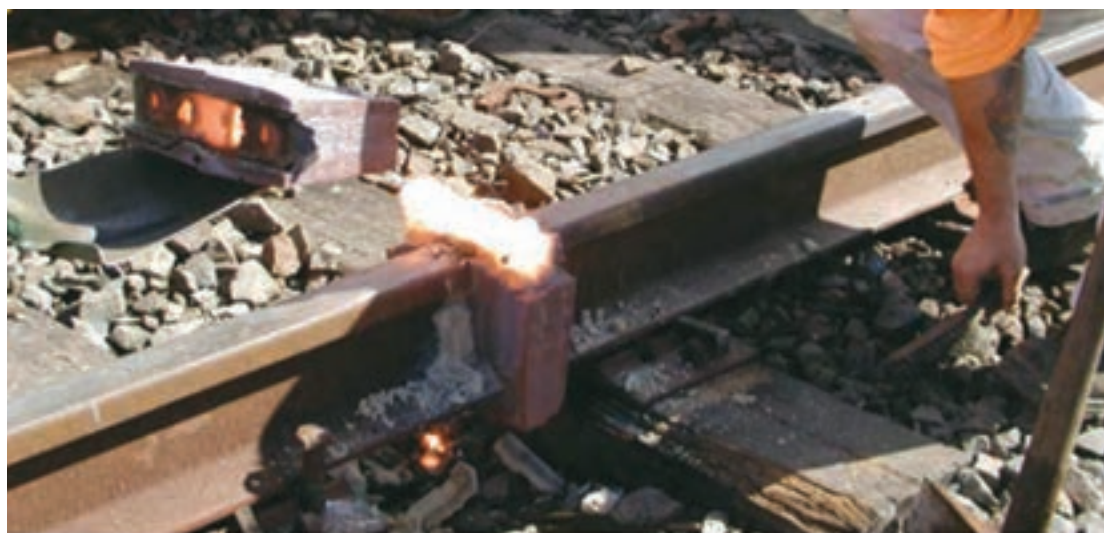
شکل ۲۷- شکستن قسمت فوقانی قالب
