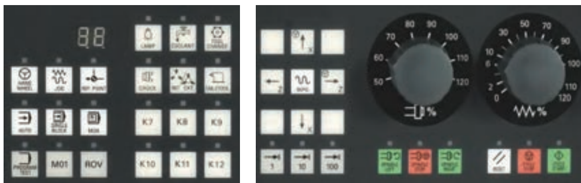
شکل ۱۷- کلیدهای اپراتوری سیستم کنترل
