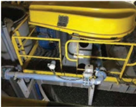
شکل ۲۷- سیستم کنترل هوا
