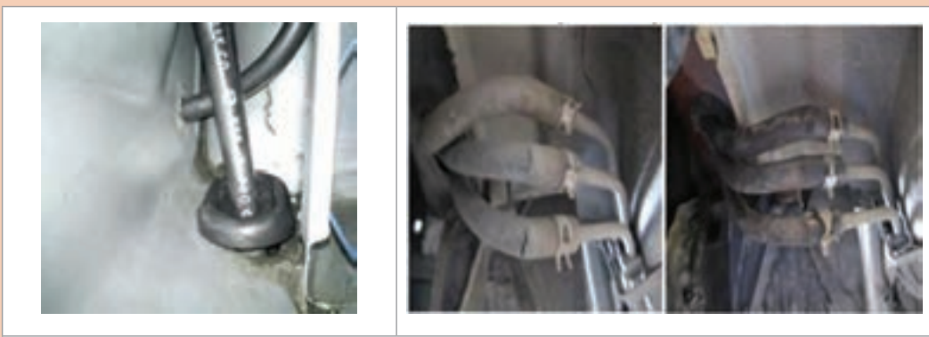
بررسی شیلنگ‌ها و اتصالات از نظر شکستگی و ترک خوردگی
