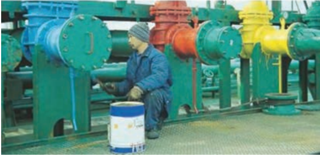
شکل ۵۵- رنگ آمیزی سامانه‌های لوله‌کشی بر روی عرشه
