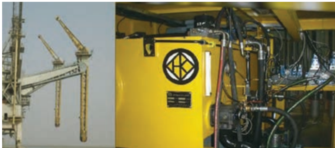
شکل ۲۱- سامانه هیدرولیک تخلیه غلات بندر امام خمینی (ره) که توسط یک شرکت داخلی نوسازی گردیده است
