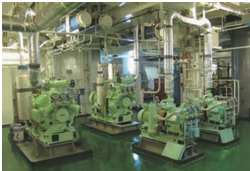
شکل ۱۹- کمپرسورهای هوا در ساختمان کشتی
