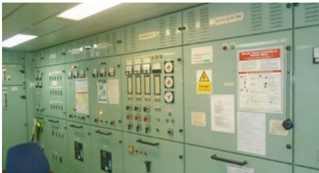
شکل ۲۳- تابلوی اصلی برق شناور
