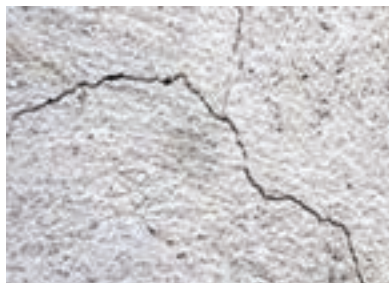
ترک خوردگی انقباضی بتن
