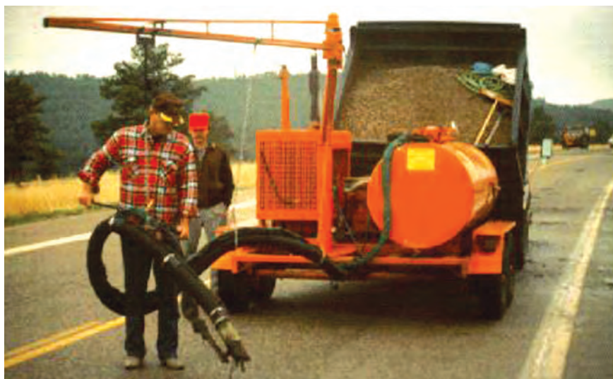
شکل ۴۴- تجهیزات تزریق فشاری
