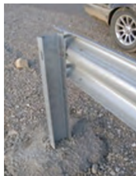
شکل ۶۳- اجرای پایه حفاظ به روش ناصحیح
