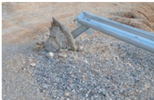
شکل ۶۴- علت غیر قابل قبول بودن اجرای پایه حفاظ با بتن
