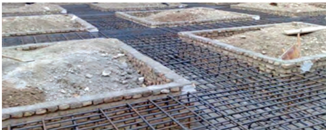
شکل ۱۴- ساخت (مونتاز) شبکه‌های آرماتور پی و آمادگی برای بتن‌ریزی و اجرای شالوده (فونداسیون) نواری بتنی مسلح، سازه‌ای اسکلتی را نشان می‌دهد.
