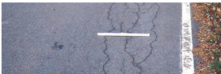
شکل ۳۷- ترک پوست سوسماری در سطح آسفالت
