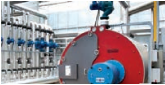
دیگ آب گرم لوله‌های انتقال آب گرم و پمپ‌ها (در یک موتورخانه سیستم گرمایش مرکزی)
