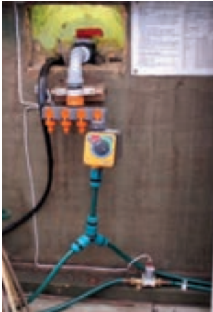
بخشی از سیستم آبیاری اتوماتیک
