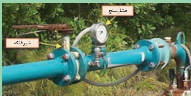
شکل ۱۳- محل شیرفلکه و فشارسنج روی لوله رانش
