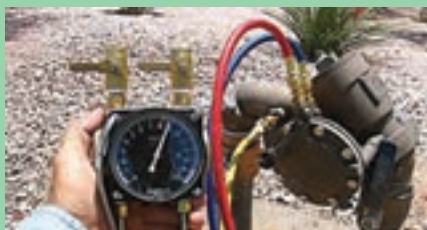
شکل ۱۷- تنظیم فشار شیر فشارشکن
