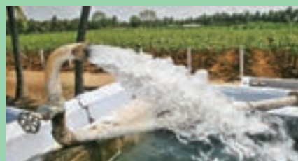
شکل ۱۶- لوله برگشت آب
