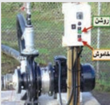
شکل ۲۰- کلیدهای کنترل روی تابلو
