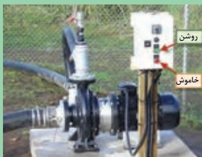
شکل ۱۴- کلیدهای کنترل روی تابلو
