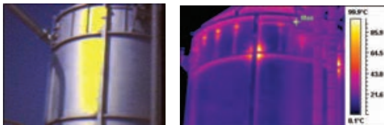
شکل ۱۳- تشخیص نشتی حرارتی از عایق مخازن
