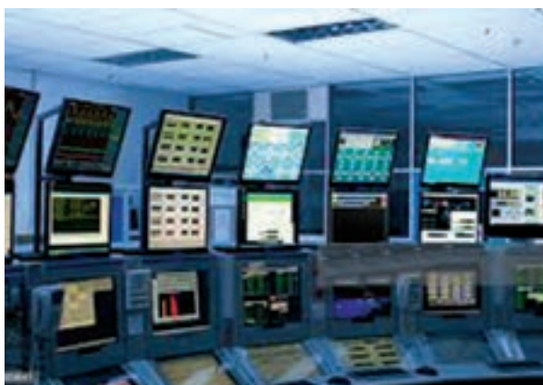
شکل ۲۸- نمایی از اتاق فرمان واحد
