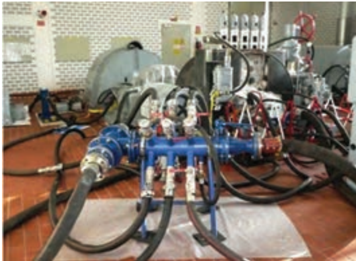
شکل ۳۰- سامانه تمیزکاری کمپرسور
