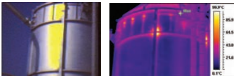
شکل ۱۳- تشخیص نشتی حرارتی از عایق مخازن
