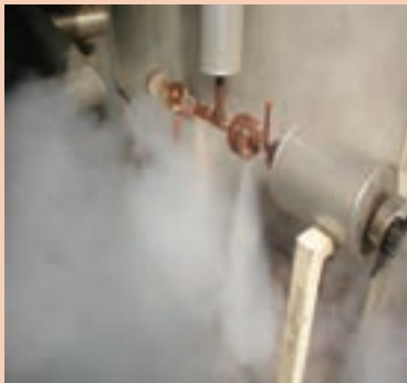
نشستی از اتصال در خط لوله
