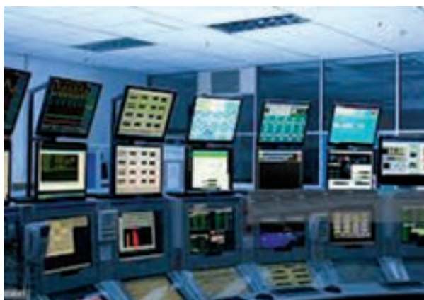
شکل ۲۸- نمایی از اتاق فرمان واحد
